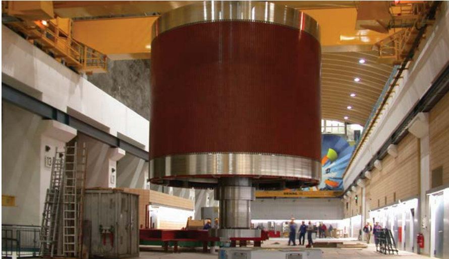
Planta hidroeléctrica de almacenamiento y bombeo Goldisthal, Alemania
