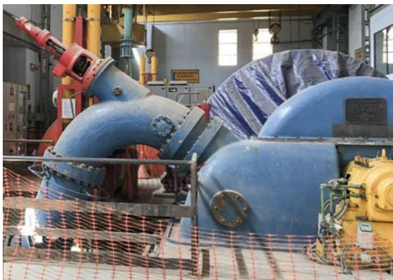
Detalle de la central eléctrica dañada
