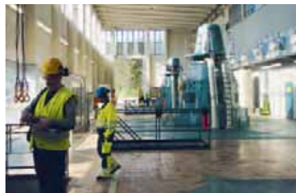
▣ Sala de máquinas de Bjurfors Övre
